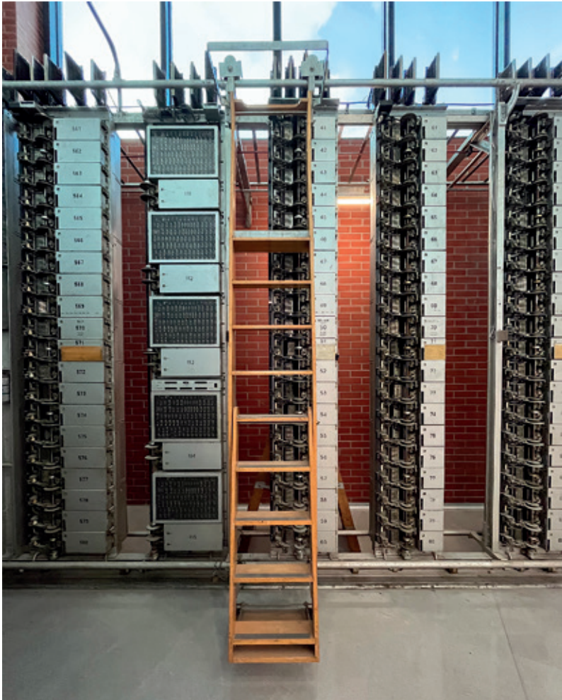
Figura 10. Antigua centralita de teléfonos de la UC, en desuso. Ubicada actualmente en la ETS de Ingeniería Industrial y de Telecomunicaciones. © EUC por G. R.
