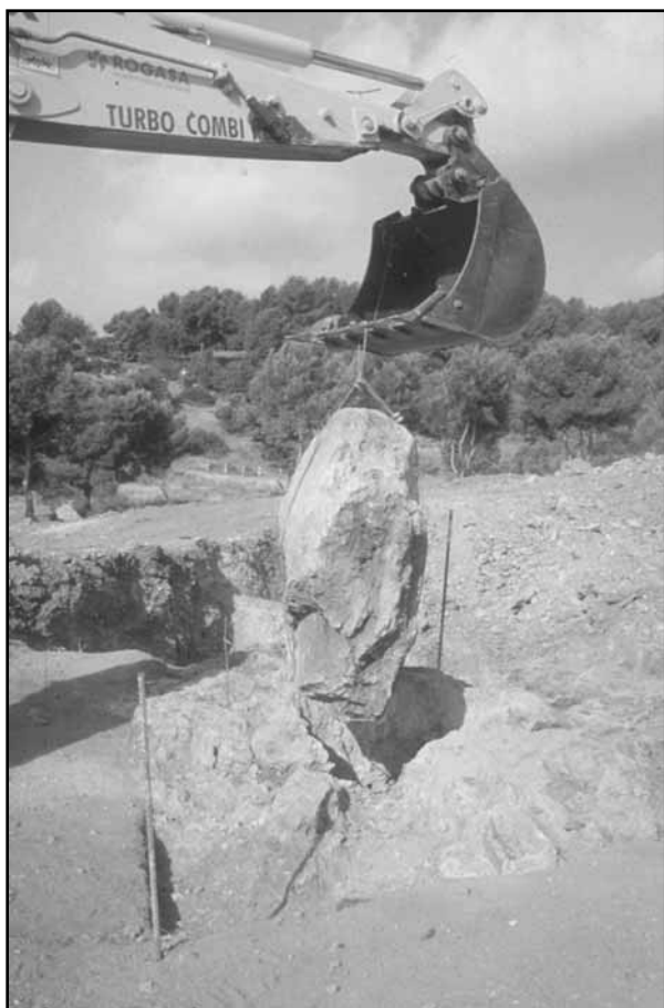
Figura 2. Vista de los trabajos de extracción del gran bloque de calcárea que clausuraba la boca de acceso a la mina 83.
